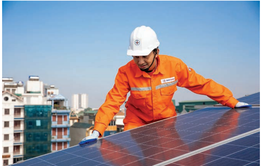
Lắp đặt hệ thống pin mặt trời giúp cơ quan giảm nhiều chi phí, chủ động nguồn điện
