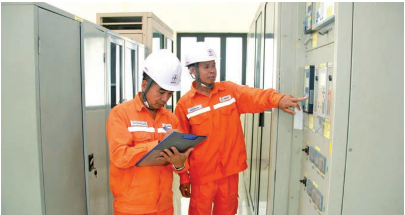
Nhân viên Điện lực khu vực Mộc Châu Vân Hồ kiểm tra, hệ thống thu thập dữ liệu đo xa tại TBA
