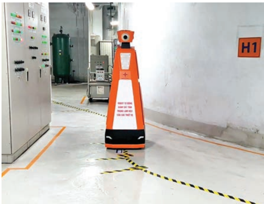
Robot giám sát thiết bị tại Công ty Thủy điện Sơn La
