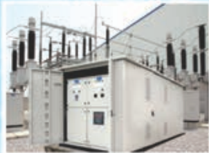
Trạm Kios Kiosk substation
