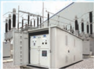
Trạm Kios Kiosk substation
