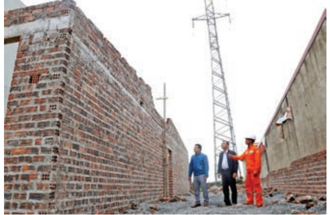
Xây dựng nhà vi phạm khoảng cách an toàn hành lang lưới điện tại huyện Kim Sơn
