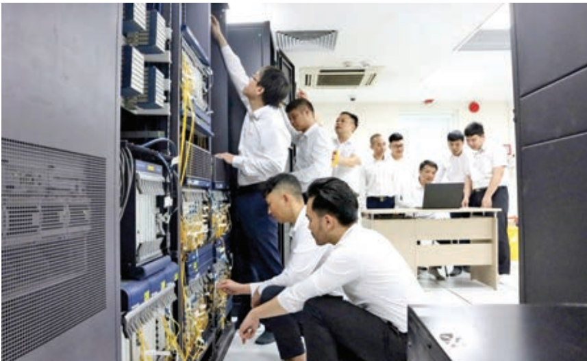
EVNNPC tăng cường đầu tư, cải tạo hệ thống viễn thông và công nghệ thông tin đảm bảo phục vụ hiệu quả cho hoạt động SXKD, đáp ứng lộ trình chuyển đổi số của ngành điện để ra
