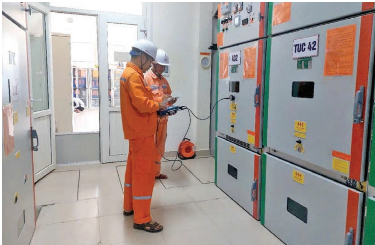
PC Hải Dương thường xuyên tăng cường nhân lực thí nghiệm hiệu chỉnh; xử lý bảo dưỡng định kỳ thiết bị. Không để sự cố do chủ quan trong công tác quản lý vận hành
