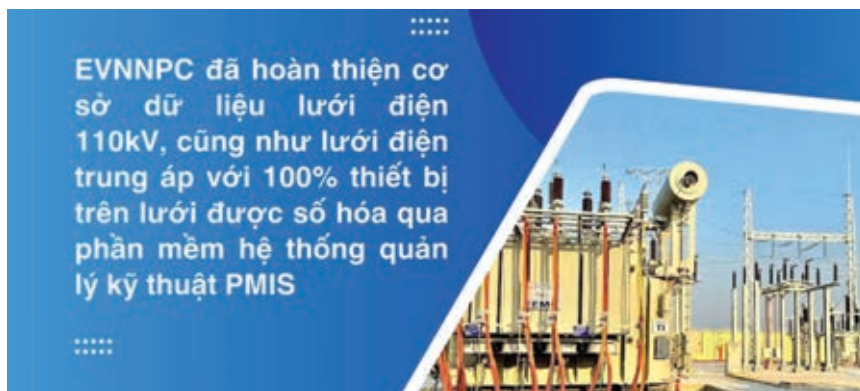
EVNNPC chuyển đổi các trạm biến áp TBA 110kV sang vận hành theo phương thức không người trực
