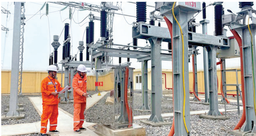
Công nhân tổ QLVH kiểm tra các thiết bị tại trạm 110 kV Rịa
