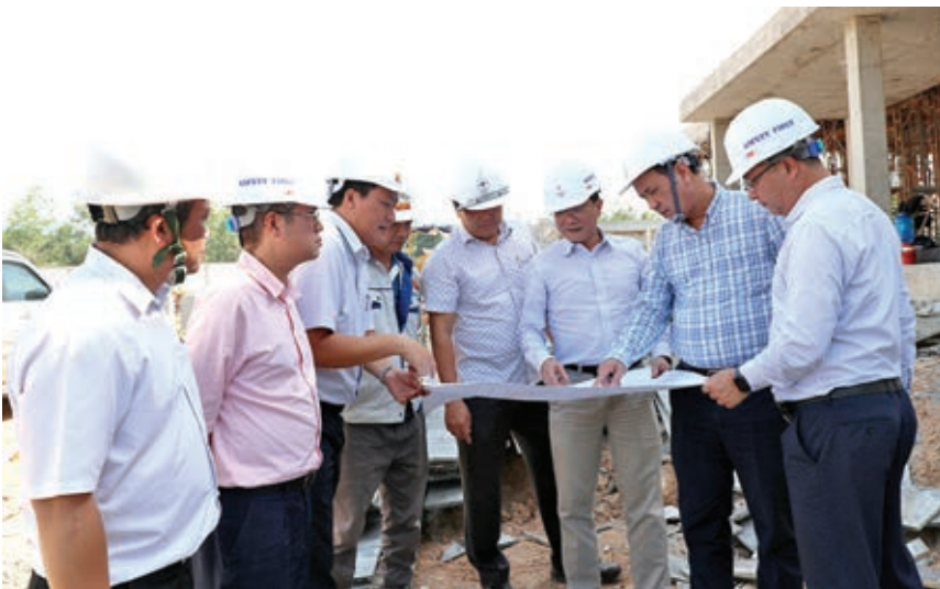
Lãnh đạo Văn phòng Ban Chỉ đạo, lãnh đạo EVNNPT nghe báo cáo tiến độ triển khai Dự án Trạm biến áp 220kV Nhơn Trạch và đấu nối.
