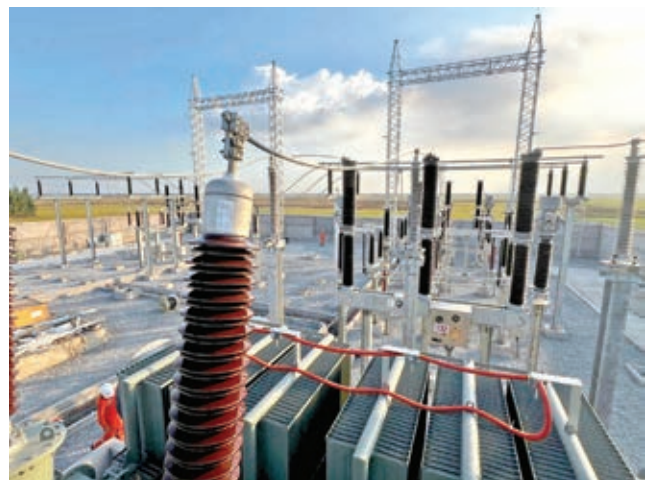
Trạm biến áp 110kV Tân Hồng, Đồng Tháp đóng điện tối 27/2
