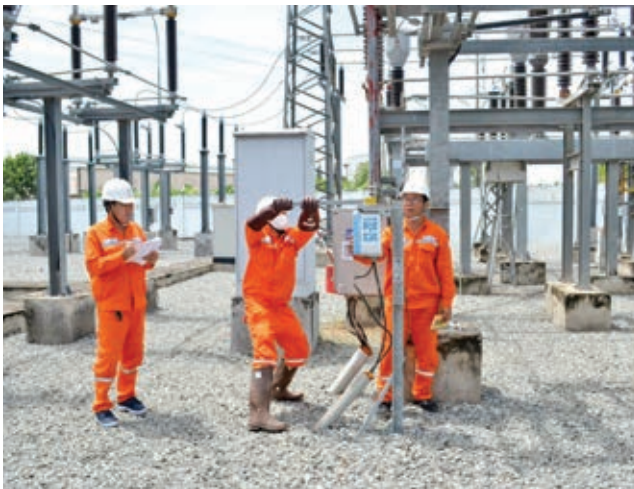
Đóng điện công trình nâng công suất “Thay máy biến áp T2-40MVA bằng 63MVA TBA 110kV” tại Gò Công, Tiền Giang
