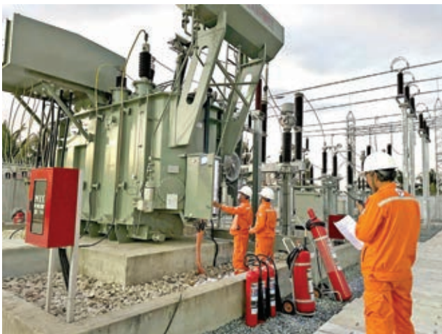
Kiểm tra các hạng mục cuối cùng trước khi đóng điện nghiệm thu kỹ thuật Trạm biến áp 110kV Phú Thuận, tỉnh Bến Tre
