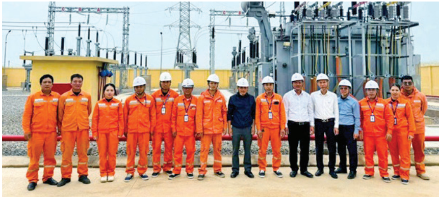
PC Điện lực Ninh Bình phối hợp các đơn vị liên quan đã đóng điện thành công dự án Đường dây trạm biến áp 110kV Rịa
