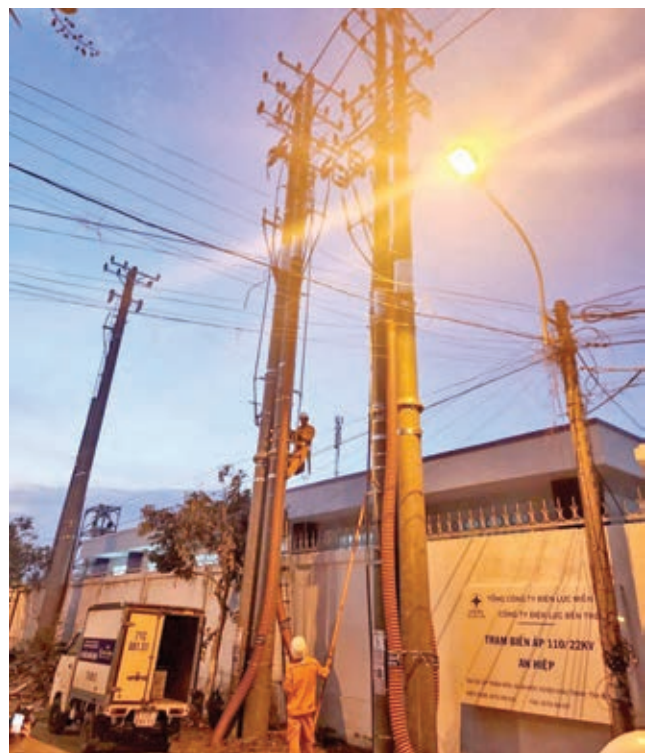
Trạm biến áp 110kV An Hiệp đóng điện tối 26/2
