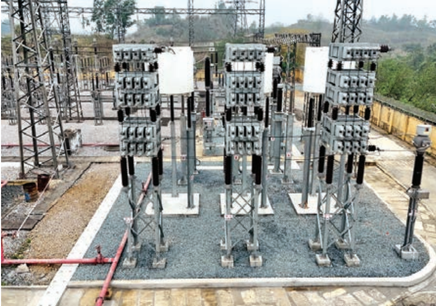
Tụ bù ngang 110kV, TBA 220kV Xuân Mai sau khi đóng điện thành công
