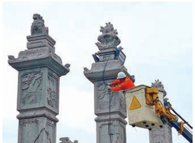
EVNHANOI đảm bảo cung cấp điện an toàn, liên tục và ổn định phục vụ các lễ hội đầu năm diễn ra trên địa bàn Thủ đô
