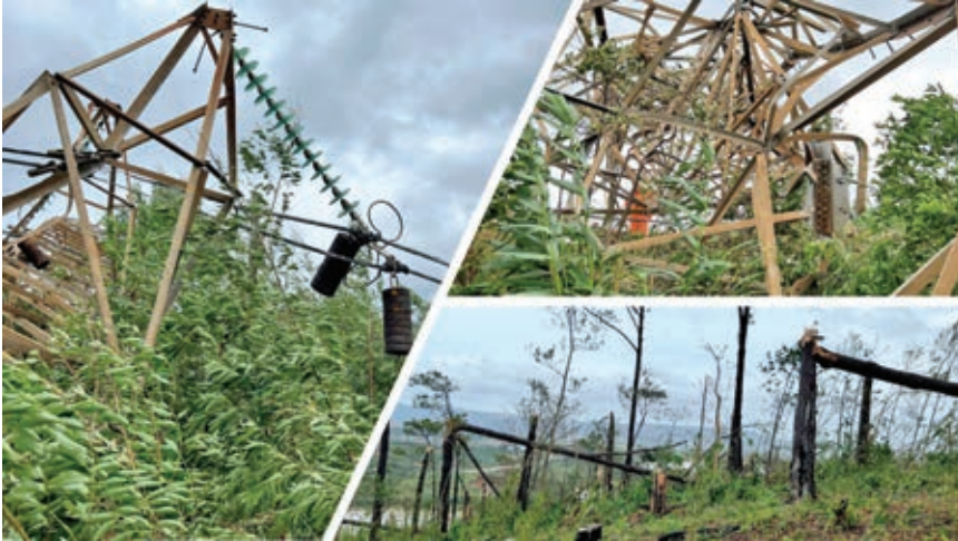
Cơn bão số 3 có tên YAGI đã gây tổn thất lớn đến hệ thống điện của các tỉnh miền Bắc
