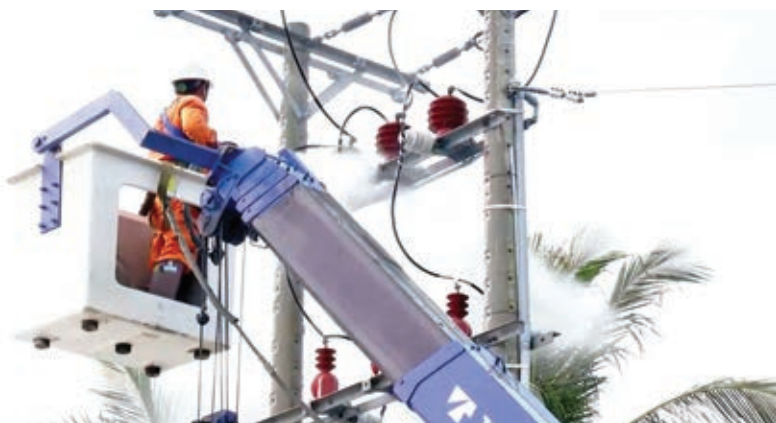
Vệ sinh trạm biến áp của khách hàng tại Bạc Liêu trong Tháng Tri ân khách hàng 2024
