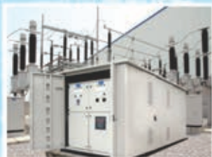
Trạm Kios Kiosk substation
