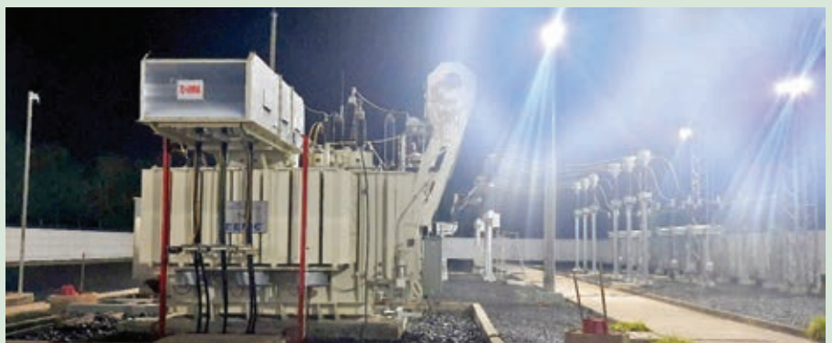
Công trình Trạm biến áp 110kV Hoa Lư (Bình Phước), đóng điện ngày 28/12
