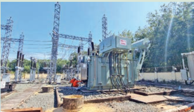
Kiểm tra trước khi đóng điện công trình Nâng công suất TBA 110kV Chơn Thành (Bình Phước) từ 2x40MVA lên 2x63MVA" giai đoạn 2, ngày 30/12
